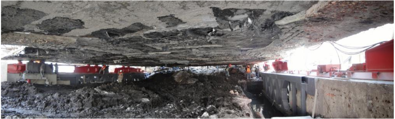
Figura 10. Vista panorámica bajo la cimentación de la casa una vez apoyada sobre los gatos hidráulicos, lista para el movimiento
