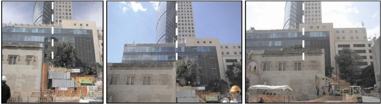
Figura 15 Secuencia donde se aprecia el movimiento de la casa tomando de referencia uno de los bordes de Torre Mayor
