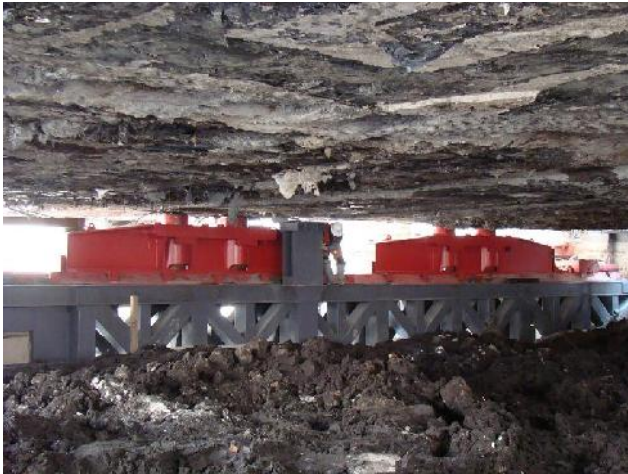
Figura 7. Vista de la armadura colocada entre los muros milán, una vez colocados los gatos hidráulicos.
